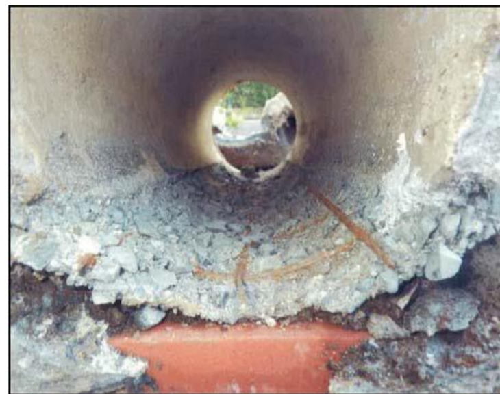
損傷した下水道管
