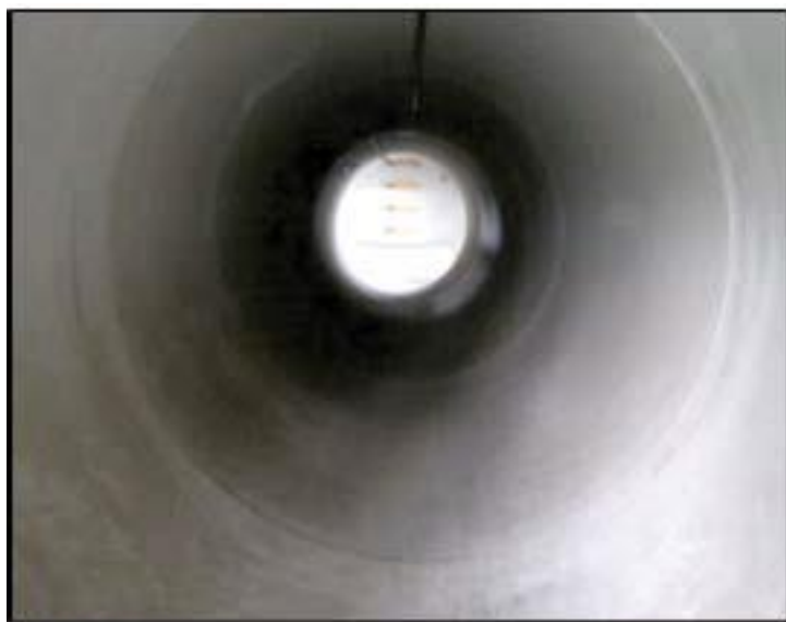
正常な下水道管
